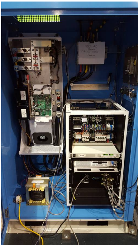
Fig. 13: Turbo-aerator motor and AMB power electronics cabinet.
